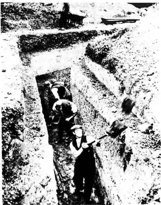
Obreros ingleses excavando trincheras en Leyton, para proteger al pueblo contra las bombas de las aviones. (Foto International).
